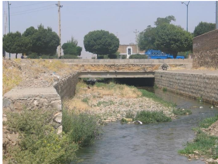
شکل شماره ۵: ابعاد و ارتفاع نامناسب پل رودخانه سنقر چای
